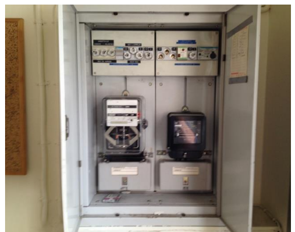
| Man kunne med fordel få fornyet og moderniseret ejendommens hovedtavler.
