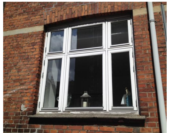
| Vinduerne mod gården er værst ramt umiddelbart.
