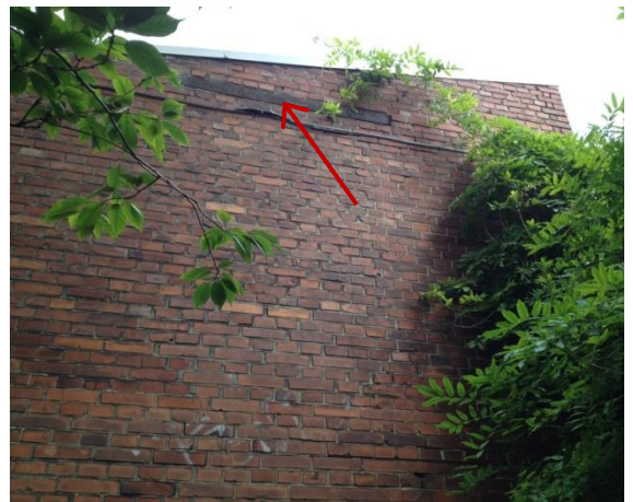
| Gavlen her er oplagt at få efterisoleret, bemærk jernbjælken øverst.
