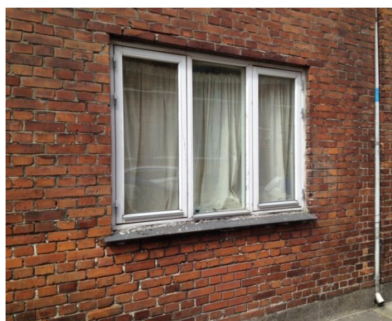
| Vinduet trænger til udskiftning, og ikke mindst fugerne omkring.
