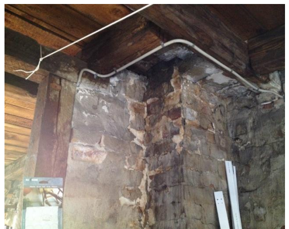
| Skorstenskeren set indefra, med massive fugtskader.
