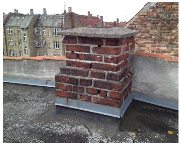
| Skorstene er meget nedbrudte, og skal bygges om.
