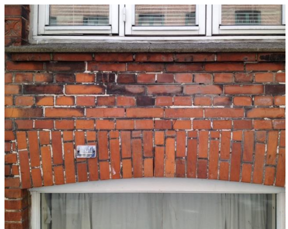
| Skaden ses også udvendigt over vinduet i murværket.
