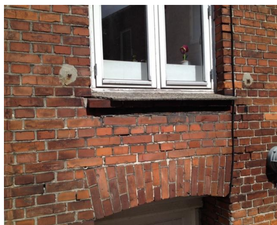
| Skadet murværk i gård, ødelagt sålbænk mv.
