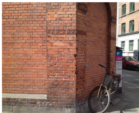
| Det mest skade hjørne i parterre.
